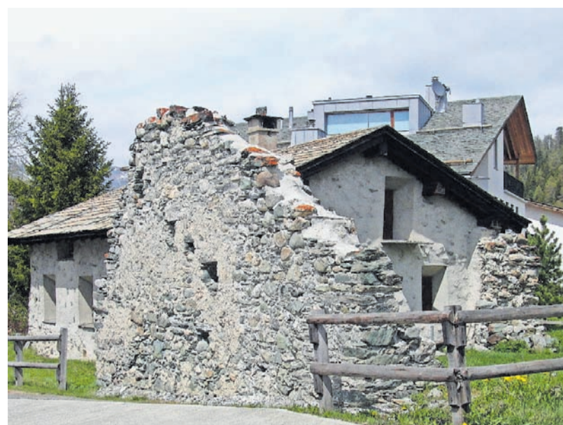
Mauerreste von Häusern in Surlej, die Ende des 18. Jahrhunderts von Rufen zerstört wurden.
